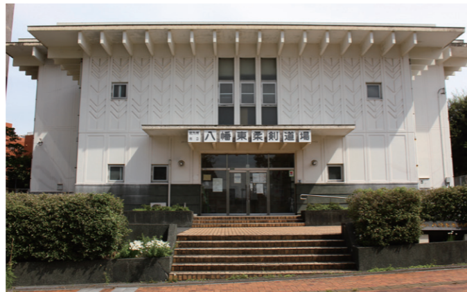
老朽化も目立ち始めた八幡東柔剣道場
